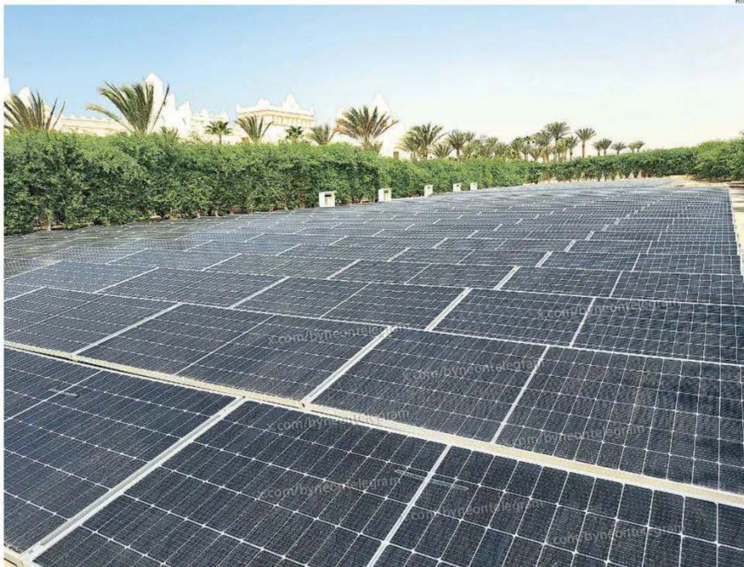
Planta fotovoltaica del Hotel Riu Cabo Verde
